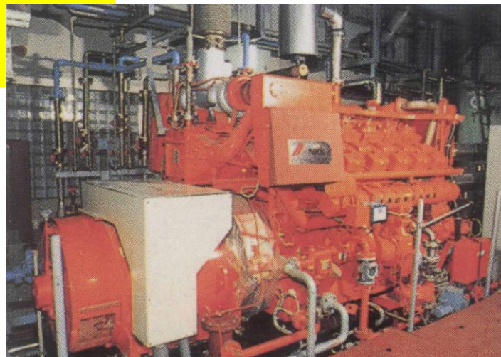
メタンガスを燃料としたガスエンジン発電
